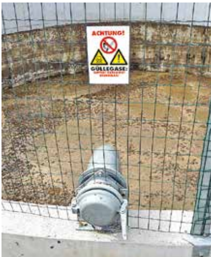
Grube mit fest montiertem Ansaugrohr und Warntafel
