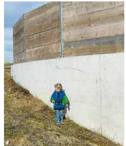
Vorbildliche kindersichere Güllegrube
